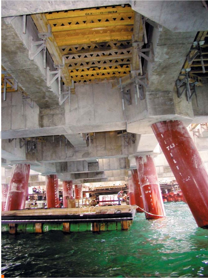
Foto 1. Soporte de losa apoyado en anclajes dejados en vigas.
