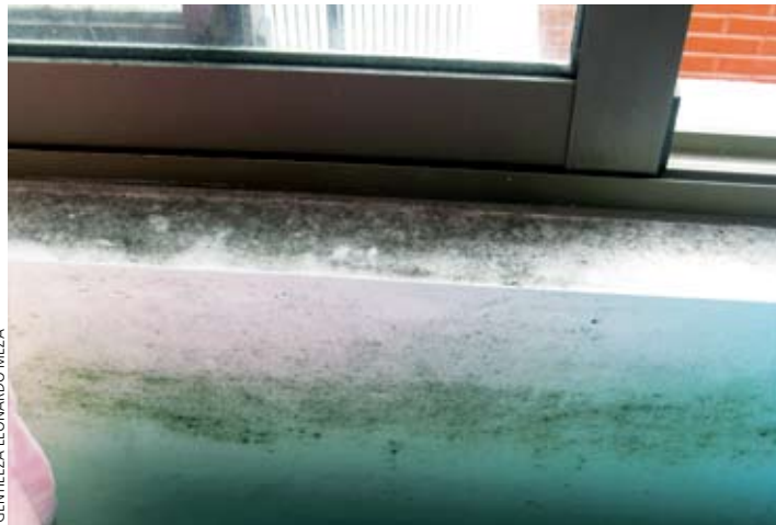
Presencia de hongos en el vano de una ventana a causa de la humedad provocada por la condensación superficial.
