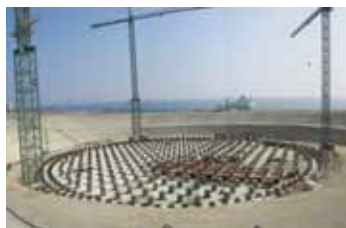
Sistema de aislamiento sísmico planta de gas GNL Mejillones
