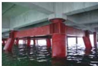
Sistema de aislamiento sísmico Muelle Coronel
