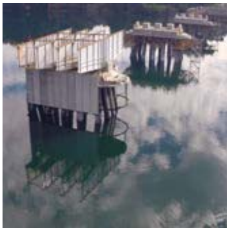
Tramo central de vigas de alto de alma de 5,2 mts. sobre cepa.
